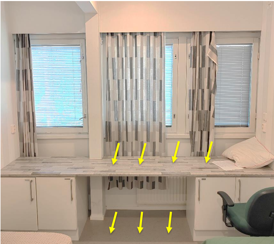
Kuva 6. Ulkoseinän eristetilasta sisäilmaan tapahtuvia ilmavuotoja havaittiin tiiliväliseinän ja alapohjan sekä pilarin ja alapohjan liittymistä (keltaiset nuolet). Kaasu syötettiin seinärakenteeseen ulkokautta
