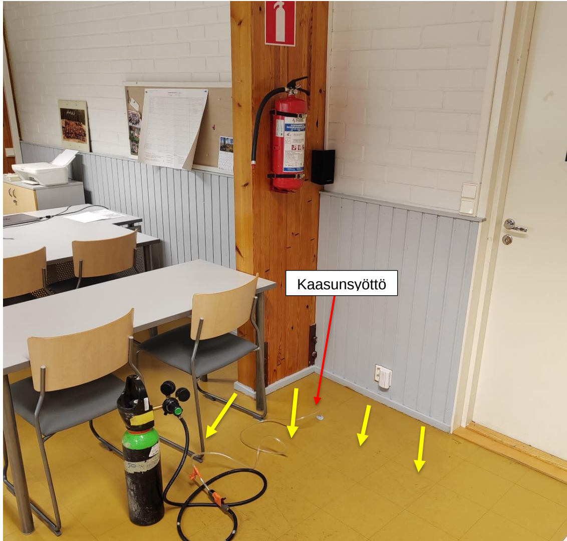
Kuva 4. Alapohjasta sisäilmaan tapahtuvia ilmavuotoja havaittiin tiiliväliseinän ja alapohjan sekä pilarin ja alapohjan liittymistä (keltaiset nuolet). Kaasunsyöttöpaikka on esitetty punaisella nuolella.
