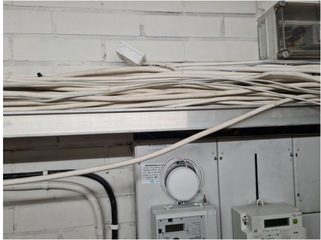
Pasi Valkeavirta 22.08.2023 10:58 Hyllyllä liikaa kaapeleita. Vaara, että kaapelit lämpenevät liikaa.
