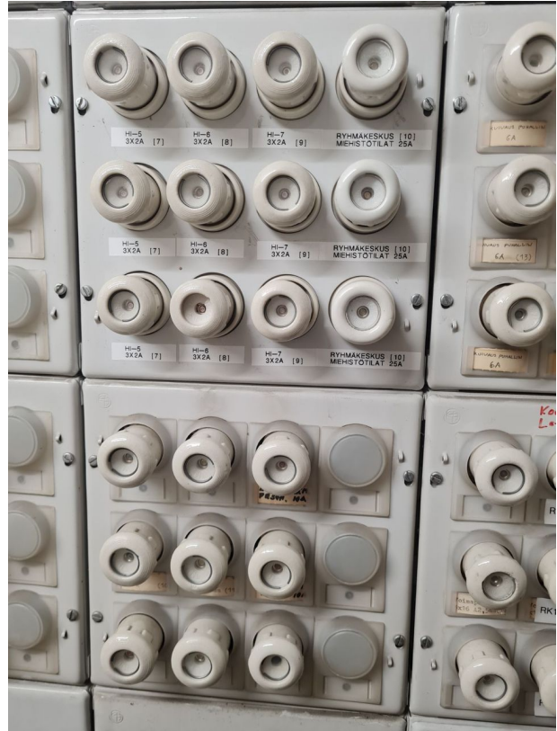
Pasi Valkeavirta 22.08.2023 10:45 Pääkeskuksessa merkitsemättömiä sulakkeita
