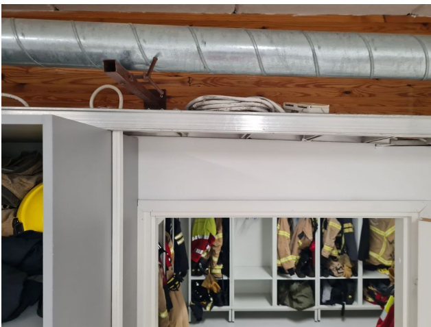
Pasi Valkeavirta 22.08.2023 10:49 Kaapelihyllyillä kiinnittämättömiä rasioita
