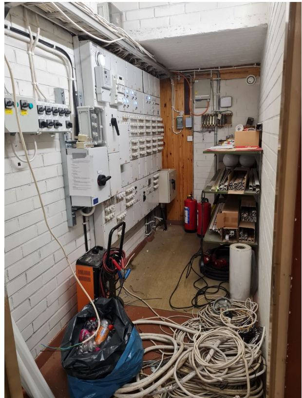
Pasi Valkeavirta 22.08.2023 10:48 Yleiskuva pääkeskushuoneesta
