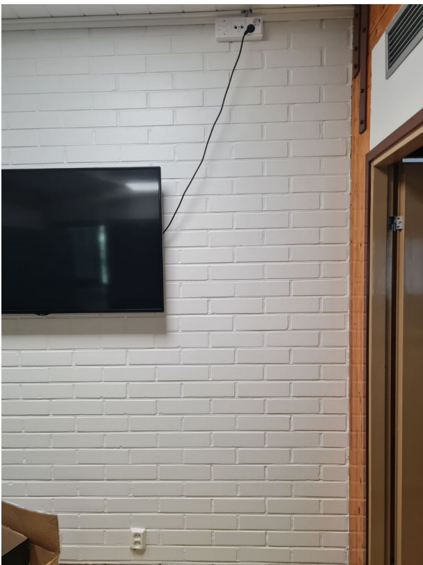
Pasi Valkeavirta 22.08.2023 10:59 Huonetilassa maadoitettu ja maadoittamaton pistorasia liian lähekkäin toisiaan.
