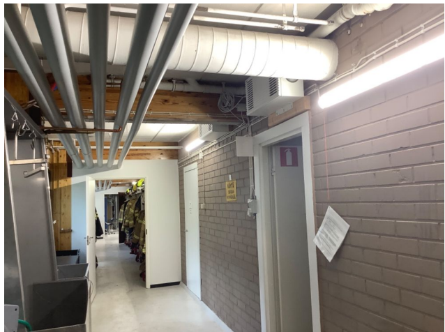
Tila 127. Entinen letkupesutila. Käytävälle on asennettu 2 kpl korvausilmapuhalltimia. Laitteiden puhallinteho 3/5, termostaatin asento normaali.
