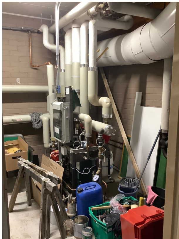
Lämmönjakohuone 117. Tilassa ei ole ilmanvaihtoa.
