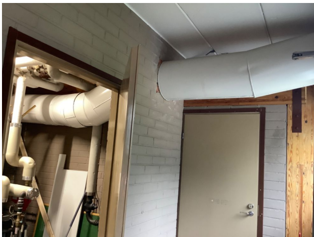
Eteinen 111. Korvausilmakanavakanava on rakennettu paineilmapullojen täyttötilaan. Kanava kulkee eteistilan ja lämmönjakohuoneeseen läpi.
