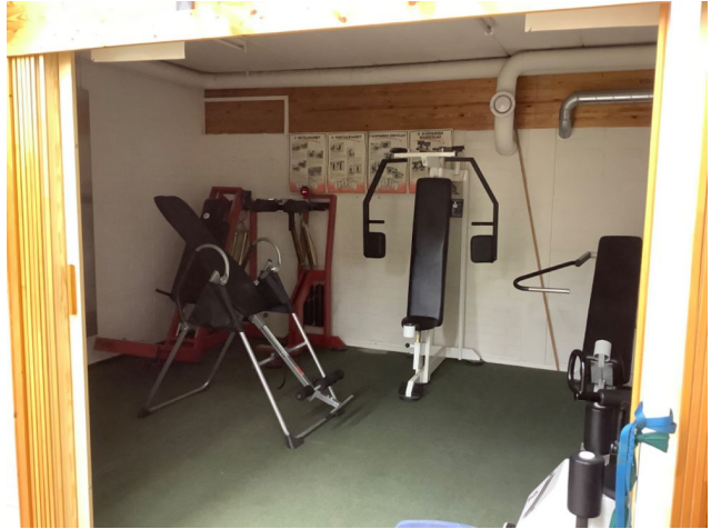
Tila 105. Liikuntasalissa olevaan vanhaan tuolivarastoon on asennettu kuntoiluvälineitä. Tilassa on poistoilmaventtiili. Tilaan tulee ilmaa salinpuolelta.
