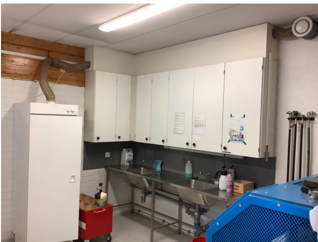
Tila 104. Kuivauskaapin poistoilma on liitetty poistoilmakanavaan.
