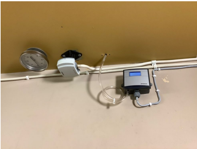
Tuloilmakanavassa on lämpötilan sekä paine-eron mittauslaitteet. Lämpötila kanavassa on n. 28 astetta.
