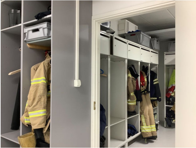
Varasto 128. Tilaan on rakennettu varusteiden säilytys. Tilassa ei ilmanvaihtoa. Takavarastotilassa on yksi korvausilmapuhallin sekä poistoilmaventtiilit.
