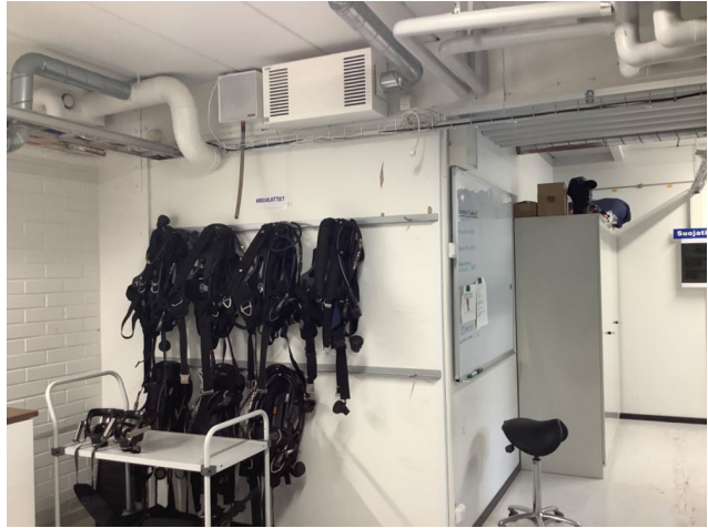
Tila 127. Vanhan letkuhuoltotilan perälle on rakennettu paineilmalaittehuolto. Tilassa on koneellinenpoistoilma sekä yksi korvausilmapuhallin. Puhallin ei ole toiminnassa.
