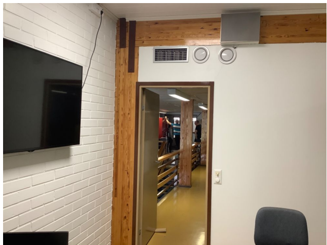
Tila 202. Tuloilmaa ei tule ollenkaan, poistoilma toimii.
