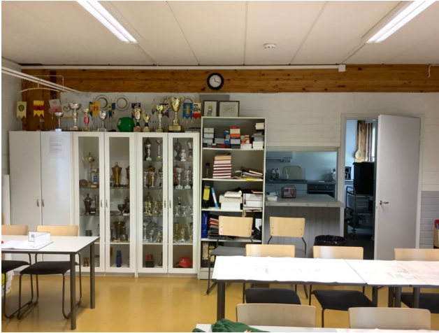
Tila 122. Kerho-/opetustila. Tilassa poistoilmaventtiilit. Korvausilma tilaan tulee kahdesta korvausilmapuhaltimesta. Toisen laitteen termostaatti on täysillä. Tilan poistoilmanvaihtopuhallin on nro 6. Poistopuhallin on ohjeistettu pitämään suljettuna ja sitä käytetään tarvittaessa.
