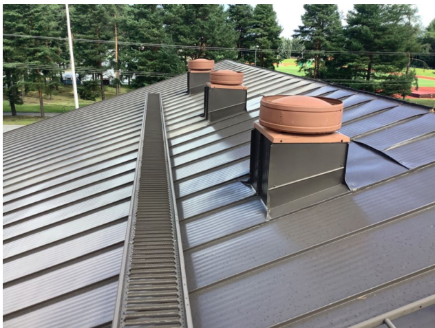
Katto. Poistoilmapuhaltimet ovat alkuperäiset.
