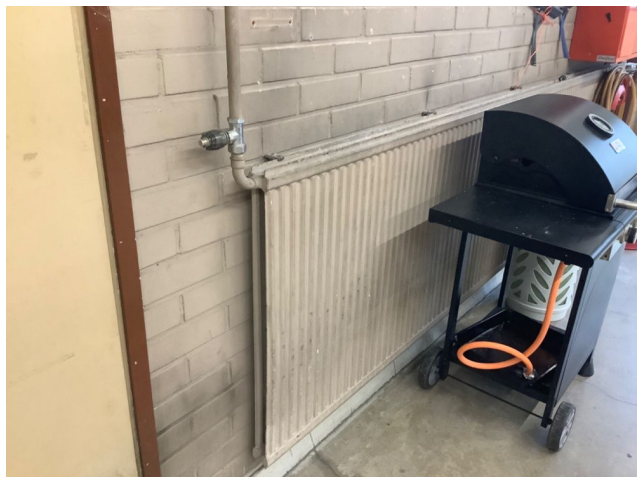
Autohallin lämmityspatteri. Termostaatti on vanha.
