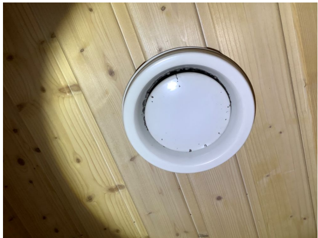
Pesuhuone 137. Poistoilmaventtiilit ovat likaiset.
