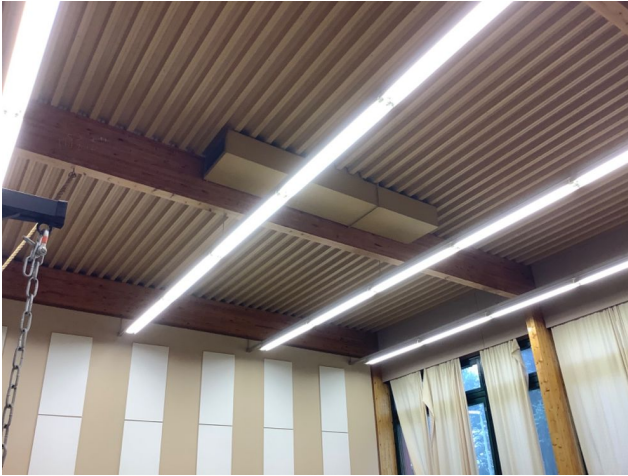
Liikuntasalin katossa on poistoilmakanava, joka on yhteydessä katolla olevaan huippumuriin (nro 7). Puhaltimen toimintaa ei tarkastettu.
