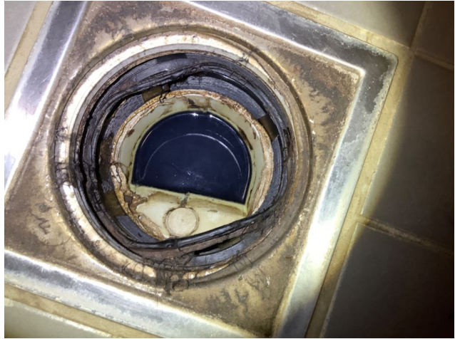
Pesuhuone 137. Suihkun lattiakaivo. Lattiakaivon tiivisteet on irti. Lattiakaivot on uusittu pesuhuonetiloihin.
