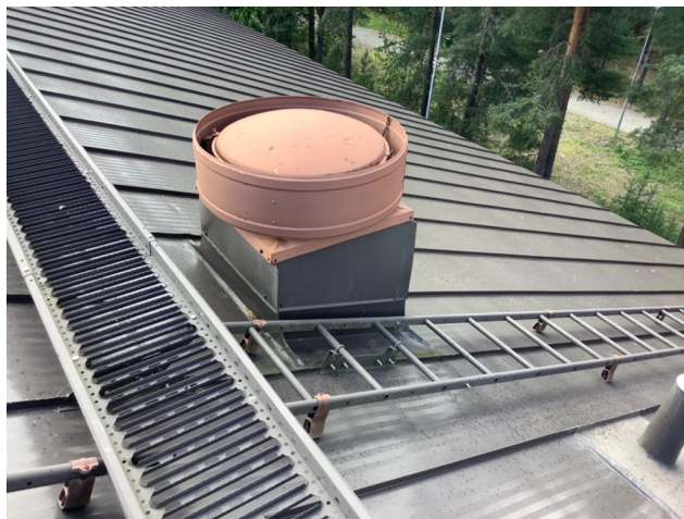
Katolla sijaitsee tuloilmakoneen ilmanotto. Ilmanottoaukkoon pääsee sadevettä sekä lunta. Ilmanottoalaite on siirretty katon uusinnan yhteydessä. Kanavassa ei ole ilman liikkumista havaittavissa.
