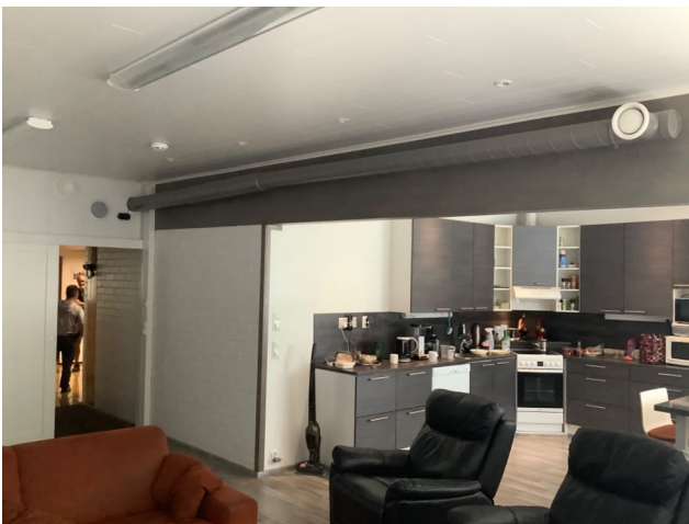
Henkilöstön tauko- ja oleskelutilassa on yksi poistoilmaventtiili + huuva ja tuloilmaventtiili. Tuloilmaa ei tule tilaan ollenkaan.
