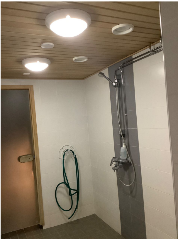
Pesuhuone 137. Tilassa on poistoilmavaihto, ei tuloilmaa. Korvausilma tulee ovirakojen kautta pukuhuone- / eteistilasta.
