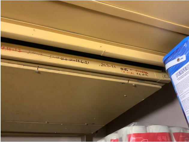
Tuloilmakoneen suodattimen vaihto on ollut todennäköisesti 20.7.2022.
