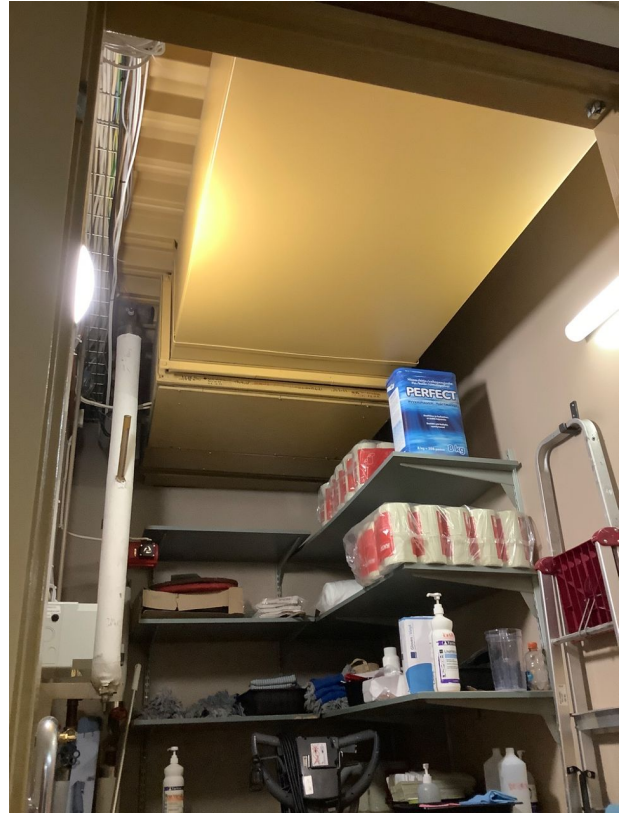
Siivouskomero 207. Tilassa on tuloilmakone, joka palvelee vain 2. kerrosta.
