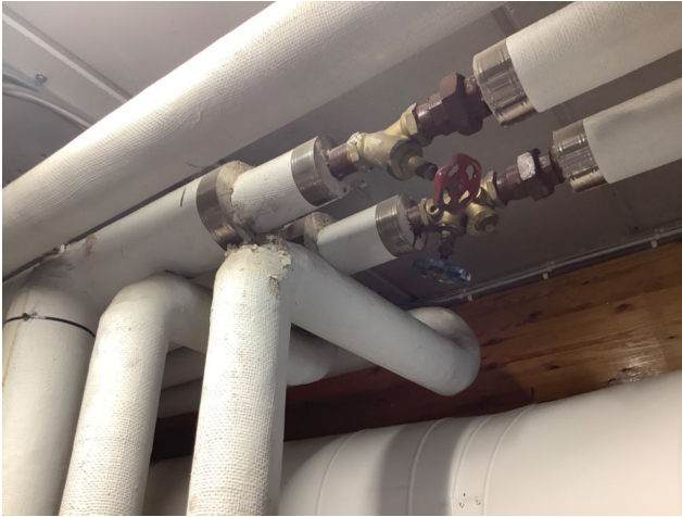
Lämmönjakuhuone 117. Putkistoeristeet ovat asbestia. Eristeet ovat vaurioituneet.
