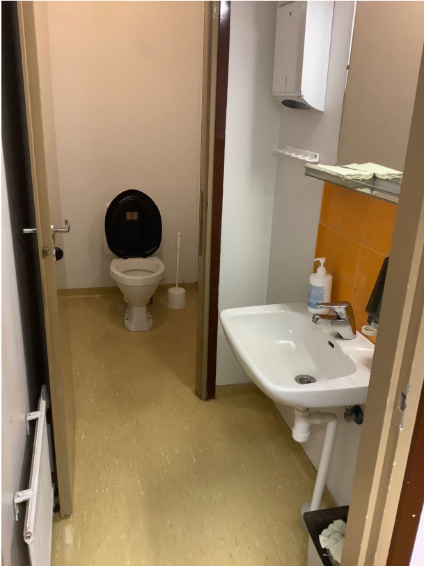
WC-tilojen ilmanvaihto on koneellinen poistoilmanvaihto ja tilaan tulee korvausilma ovirakojen kautta.
