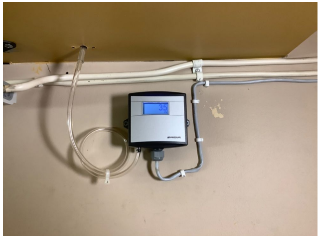
Tuloilmakanavan paine-ero on 3,5 Pa. Kanavassa ei ole ilmanvirtausta.
