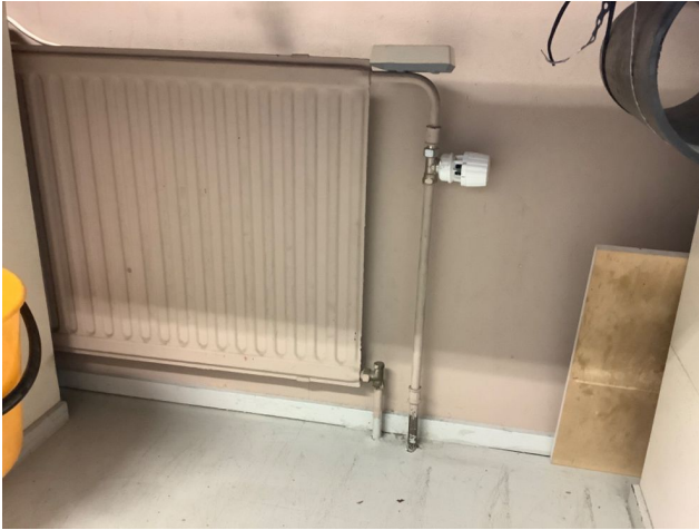
Esimerkkikuva alakerran lämmityspatterista. Lämpöjohdot on asennettu alapohjalaattaan. Lämmityspattereiden termostaatteja on uusittu.
