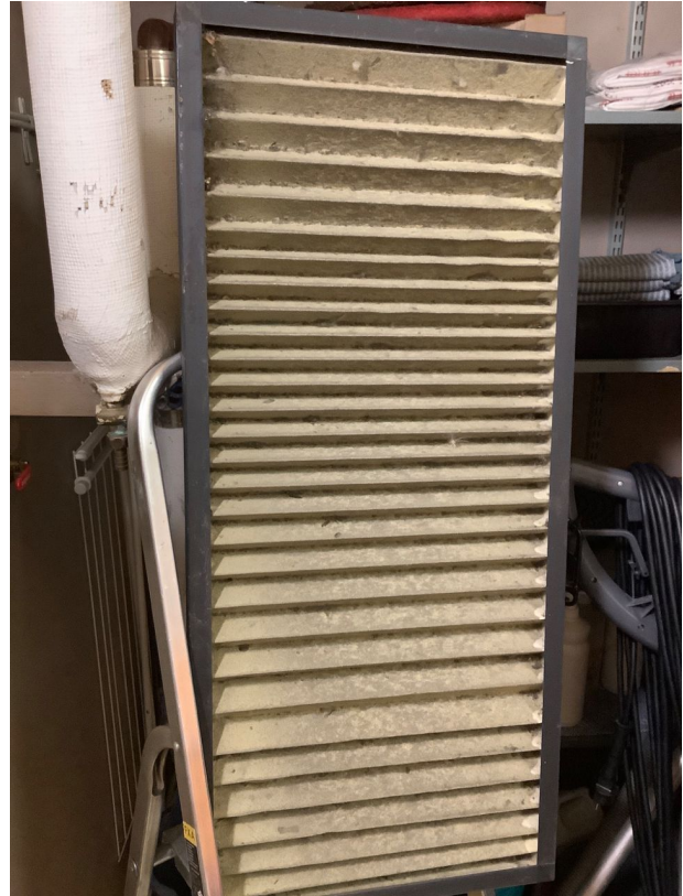
Tuloilmakoneen suodatin on merkinnän mukaan vaihdettu 20.7.2022. Suodattimessa on vain vähän likaa. Raitisilmakanavassa on jokin ongelma, mahdollisesti tukos, joka tulee selvittää pikaisesti. Lisäksi tuloilmakoneen toiminta tulee tarkastaa samalla.
