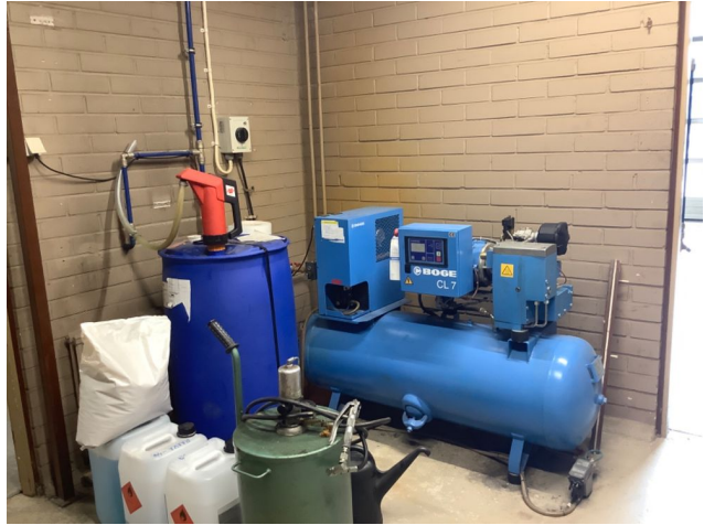
Varasto 116. Tallin takana kompressorin / varastotila. Ei ilmanvaihtoa.
