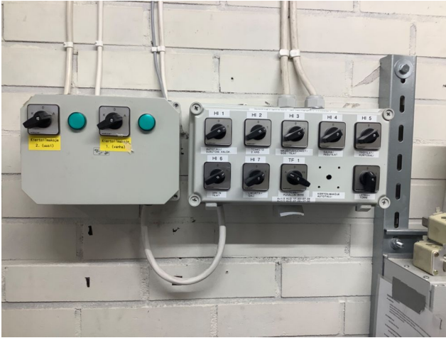
Säköpääkeskus 119. Poistoilmapuhaltimeiden sekä tuloilmapuhaltimeiden ohjainlaitteet on päivitetty.
