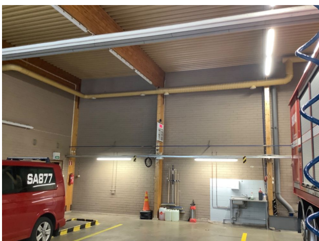
Autohalli 112. Tilassa on poistoilmavaihtokanava yleisilmanpoistoa varten. Tilassa ei ole pakokaasuimuria. Tilassa ei ole tuloilma-/korvausilmalaitteita. Tilan poistoilmapuhallin on nro 1.
