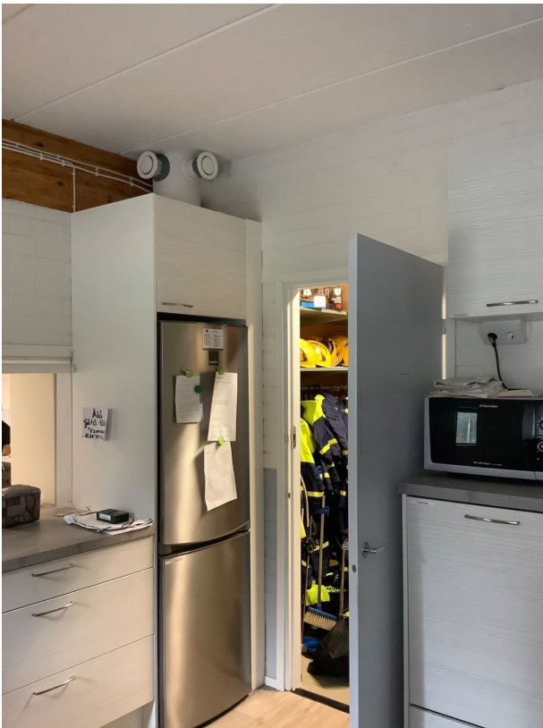
Tila 121. Alakerran kerhotilan keittiötilassa poistoilmaventtiilit. Tilaan tulee korvausilma viereisen kerho-/opetustilan kautta (tila 122).
