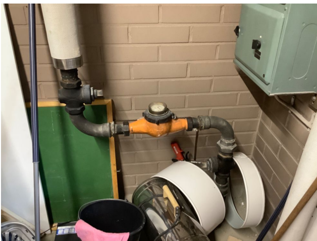
Vesimittari sijaitsee lämmönjakuhuoneessa.
