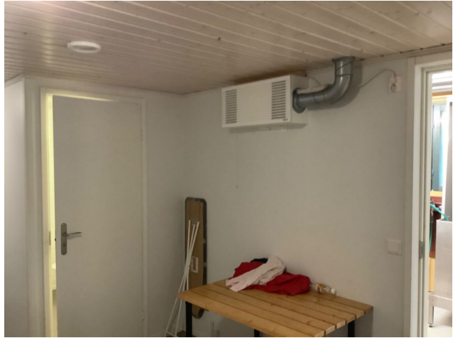
Puhukuone 134. Tilassa on Mobair-korvausilmpuhallin.
