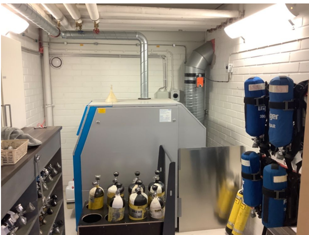
Varasto 118. Tallin vieressä olevaan varastoon on rakennettu paineilmapullojen täyttötila. Korvausilmakanava tulee tähän tilaan. Tilassa poistoilmaventtiili.
