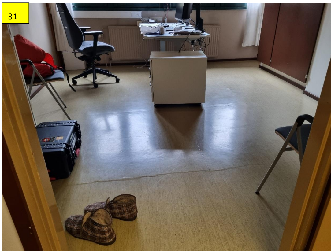
Kuva 31. 2.krs toimistotilan lattiassa lattiapinnassa muodonmuutoksia.
