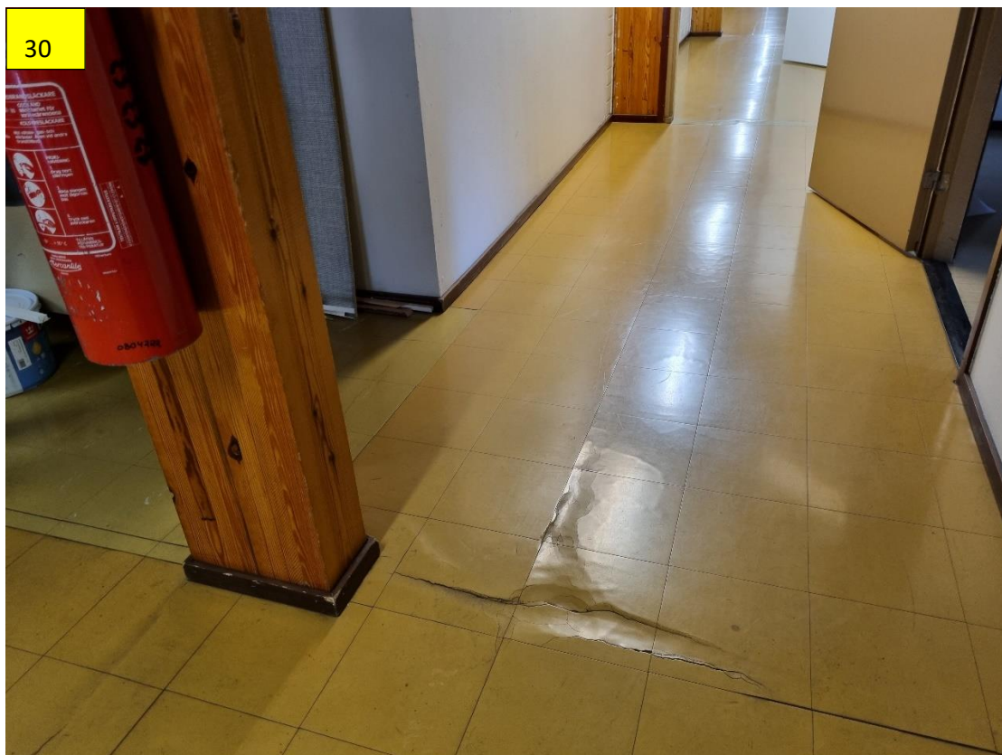
Kuvat 29 ja 30. Siporex-välipohja, 2krs käytävän lattiapinnoilla havaittiin useita halkeamia ja muodonmuutoksia/murtumia.
