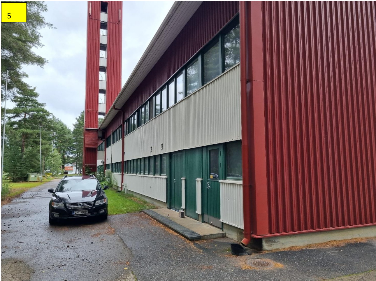
Kuva 5. Rakennuksen vierustat ovat pääsääntöisesti asfaltoituja. Nurmialueilla pintojen kallistukset ovat paikoin puutteellisia, mutta sokkeleissa ei havaittu näillä kohdin merkittäviä kosteusviitteitä.
