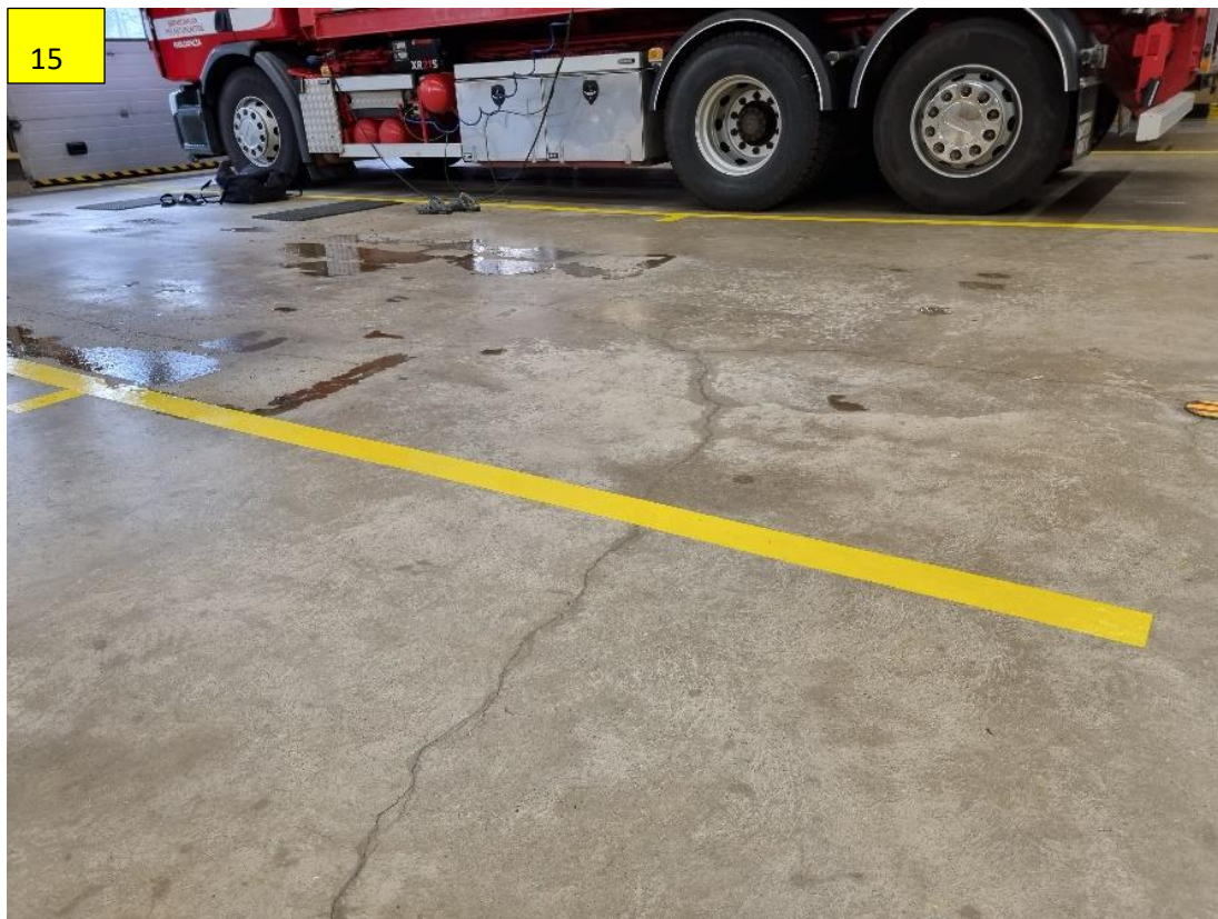
Kuva 15. Autohallin lattiaan kertyy ajoneuvoista ja lattiapesuista vettä, joka aiheuttaa kosteuskuormaa alapohjarakenteeseen. Lattioissa havaittiin halkeilua.
